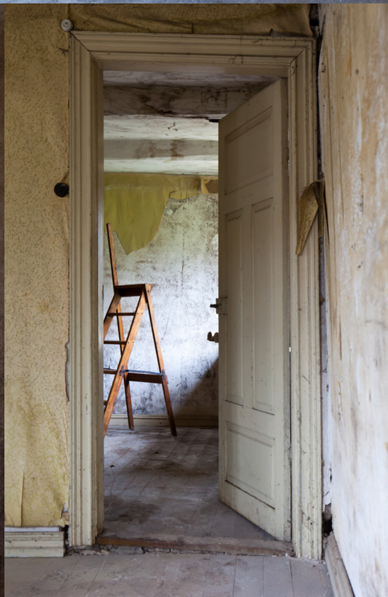
Tapetbitar från väggarna i tele- fonstationen.
